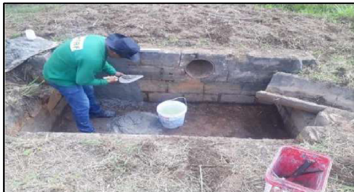
Figura 64: Atividades de manutenção do aterro encerrado da Muribeca: manutenção da caixa de passagem
