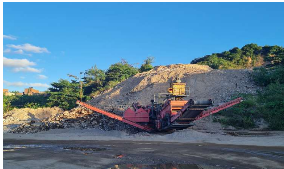
Figura 54: Britador na usina de beneficiamento de RCC
